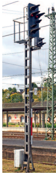
Ausfahrtsignal mit Gleissperrsignal auf grauem Mast
